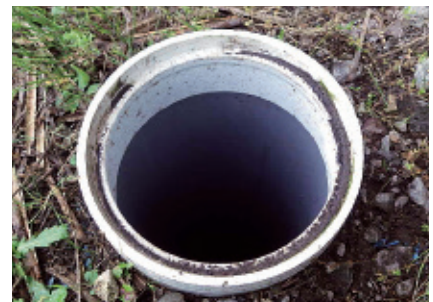
× (蓋が破損し開いている状態)
