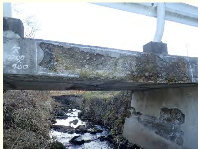
健全度 IV : 蟹原 2 号橋(主桁ひびわれ・たわみ)
