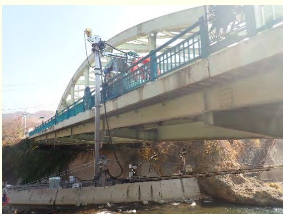
橋梁点検支援用ロボット
