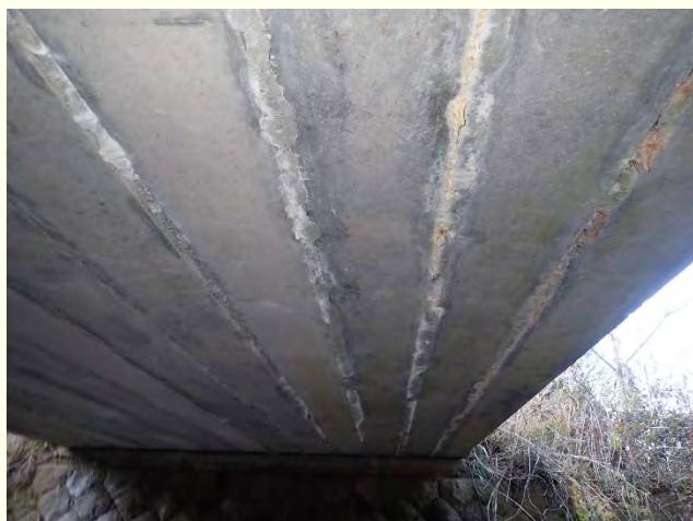
健全度 III : 笹の塔橋(つらら状遊離石灰)
