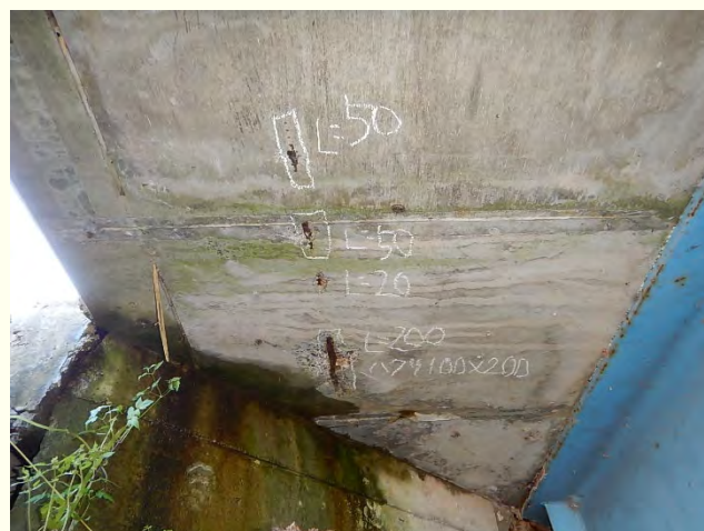
健全度 II : 水源地橋(鉄筋露出)
