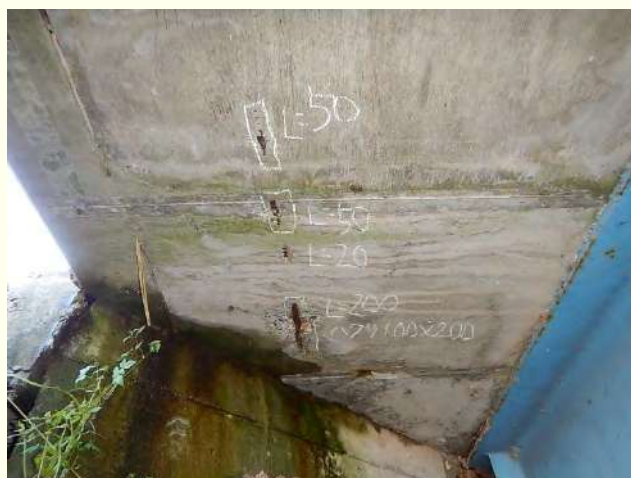
健全度 II : 水源地橋(鉄筋露出)
